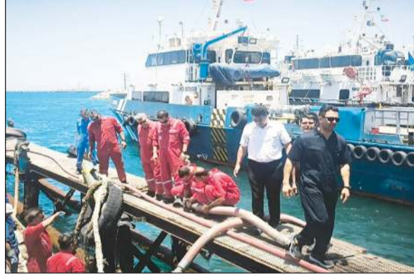
توجه به گستردگی آسیب‌های ناشی از خوردگی و پوسیدگی، راهکاری فنی و متناسب با شرایط موجود طراحی و اجرا کرد.
